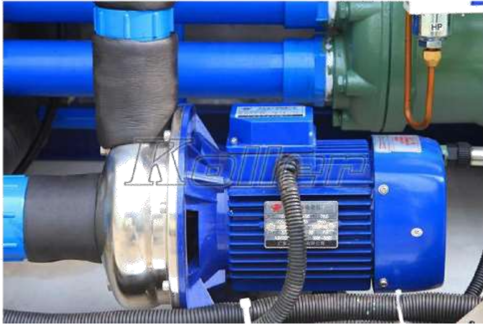
Bomba de Recirculación de agua
